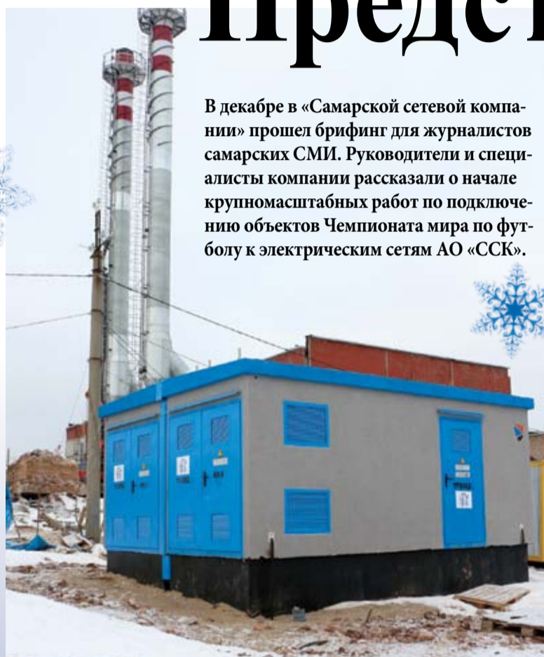
Новая трансформаторная подстанция обеспечит надежным электроснабжением котельную «Жигулевские сады» и даст ей необходимую мощность в 770 кВт.
