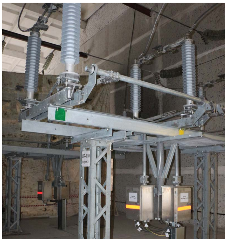
На объекте были установлены новые линейные разъединители 110 кВ с двумя заземляющими ножами.
