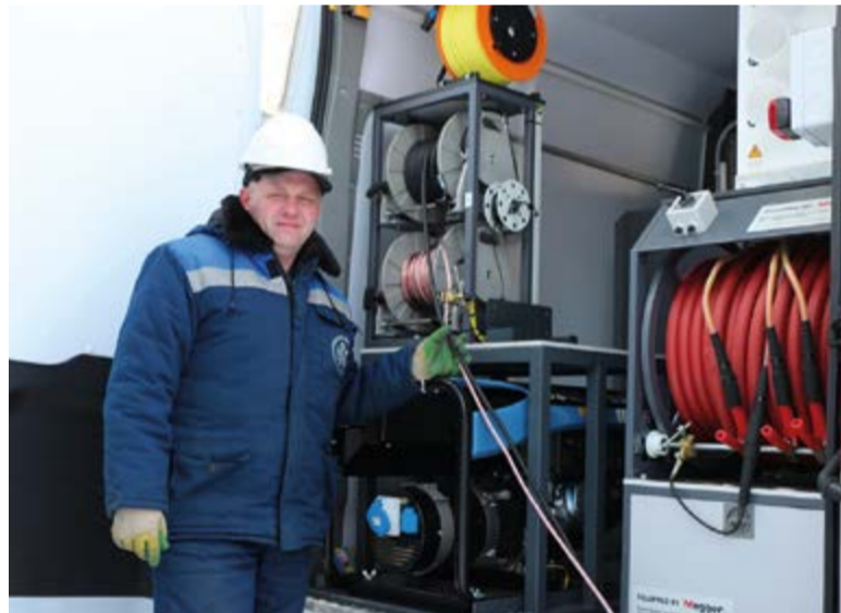
Электротехническую лабораторию подключают к поврежденному кабелю.
