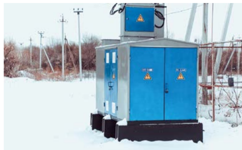
Обновленная ТП мощностью 400 кВт в Хрящевке обеспечивает бесперебойным электроснабжением жителей села.
