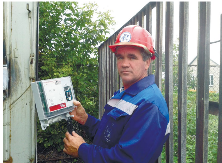
→ УСТАНОВКА НОВОГО МАРШРУТИЗАТОРА НА ТП. На фото электромонтёр Сергей Александрович Захарков.
